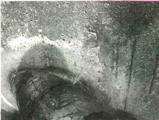
水管橋護岸コンクリート際の管路溶接部付近で漏水
