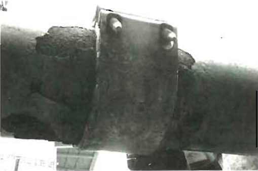
目視点検などで漏水確認
